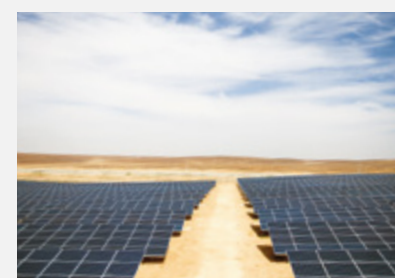
La centrale solaire photovoltaïque du camp de réfugiés d'Azraq s'étend dans le désert en Jordanie.
